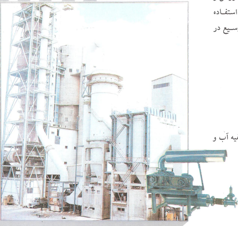
بلوئر PVI - RB نصب شده بر روی سیستم انتقال و هوادهی سیلو در کارخانه سیمان ۲۰۰۰ تنی
